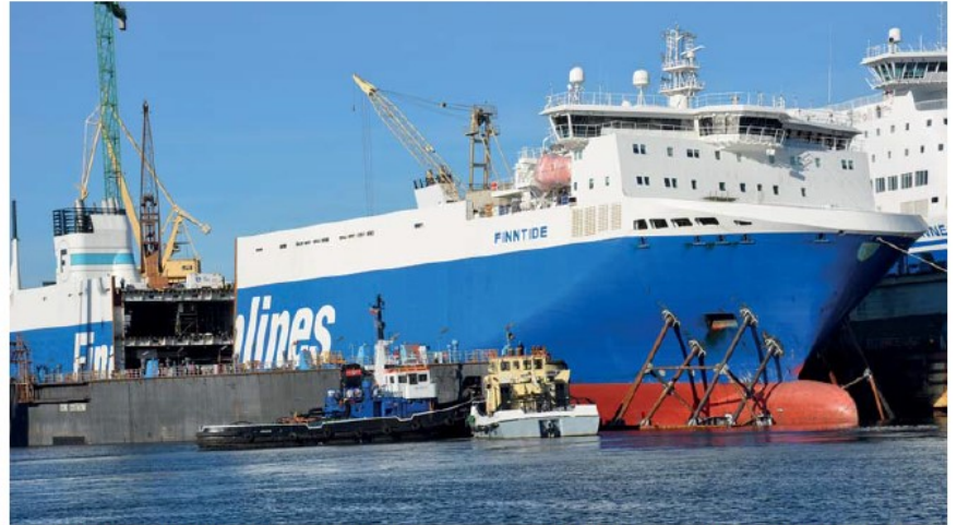
El "Finntide" fue cortado en el astillero de Gdansk en dos secciones y se insertó otra sección adicional de unos 30 metros.
